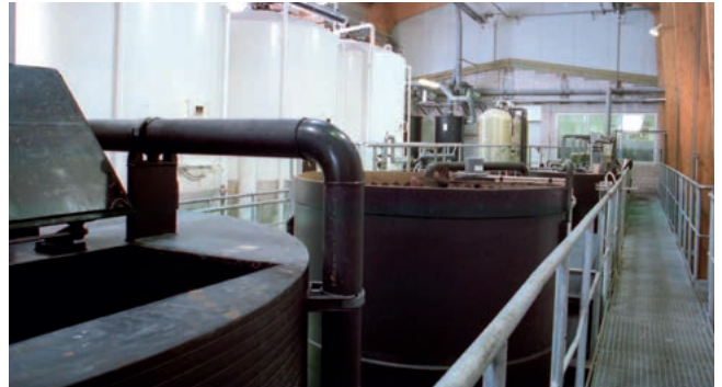
PE sewage plant
